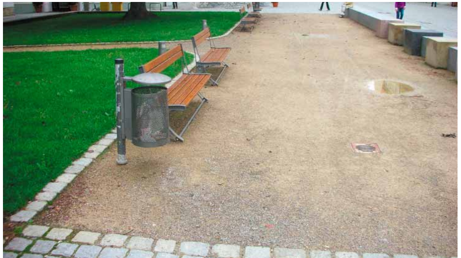
Typisches Schadensbild des wasser gebundenen Wegs: Ausschwemmungen, durchgearbeitete Decke und Pfützenbildung am Beispiel Kempten Rathausplatz.
